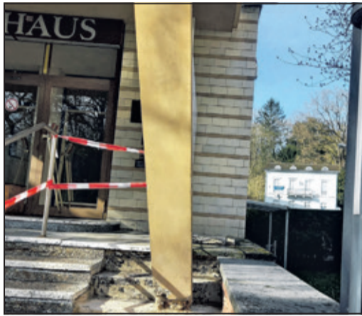
Hier hat der Zahn der Zeit genagt: die Stütze des Rathausvorbaus. Foto: Stadt Bad Soden
