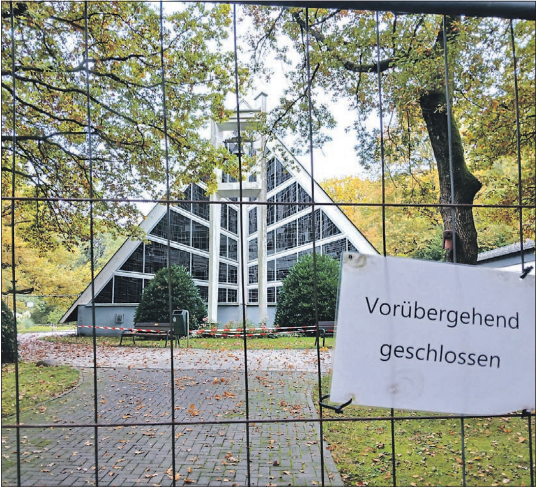
Ein Bauzaun versperrt zurzeit den Weg zur Trauerhalle auf dem Waldfriedhof. Im November soll der einsturzgefährdete Glockenturm gesichert werden. Danach will die Stadt die Trauerhalle wieder freigeben. Foto: Schlosser
