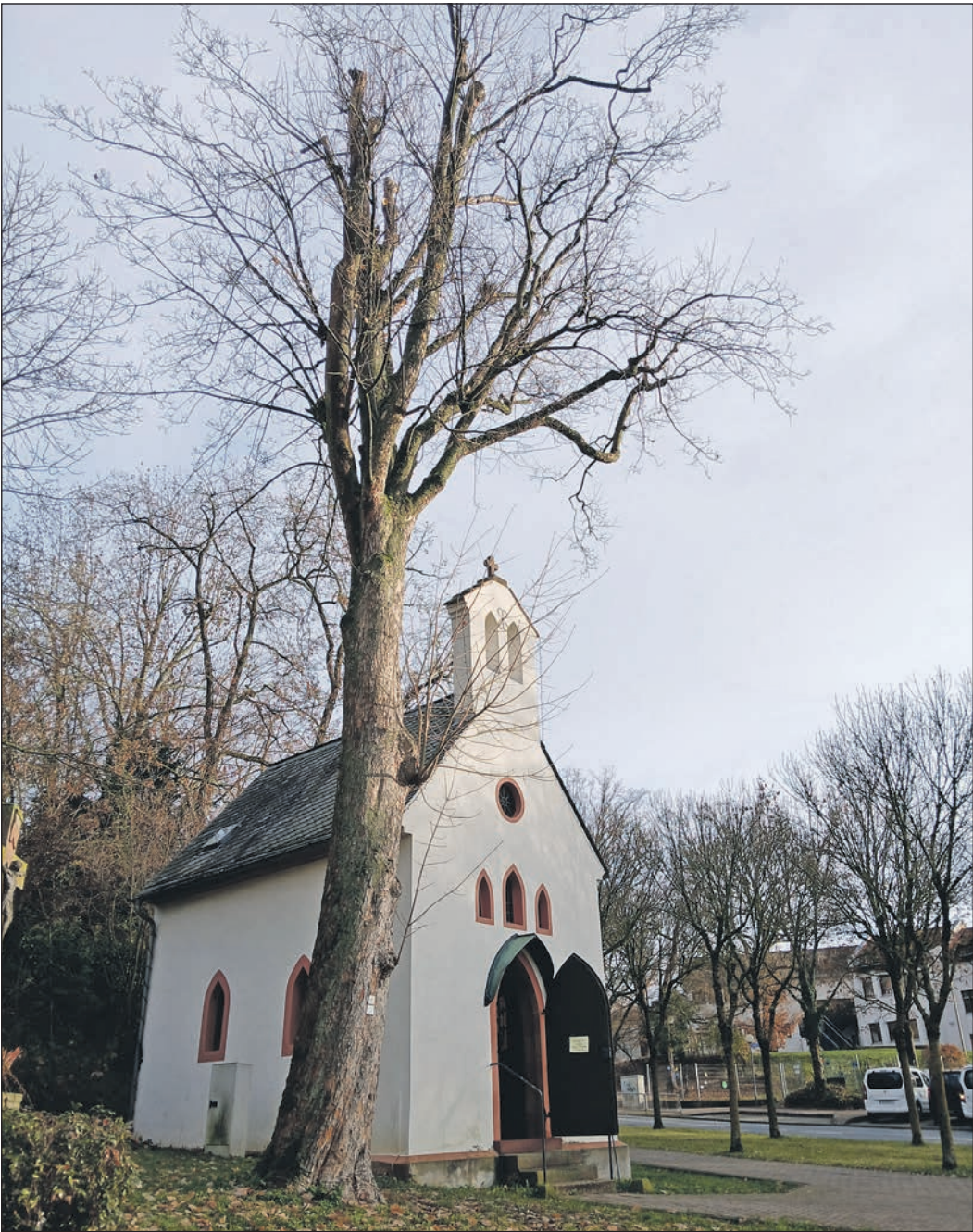
Bei einer Routinekontrolle hat der städtische Umweltschutzbeauftragte Maximilian Schneider am Stammfuß des großen Ahorns an der Alten Kapelle eine Faulstelle entdeckt. Der Schaden gefährdet die Standfestigkeit des Baumes. Ein Gutachten hat mittlerweile die Notwendigkeit einer Fällung aus Gründen der Verkehrssicherheit bestätigen. Die Arbeiten sollen am Montag, 1. Dezember 2025, stattfinden. Der Baum soll zeitnah ersetzt werden. Laut Maximilian Schneider wird ein widerstandsfähiger und klimastabiler Baum gewählt. Dadurch soll das Ortsbild langfristig erhalten bleiben. Foto: Schlosser
