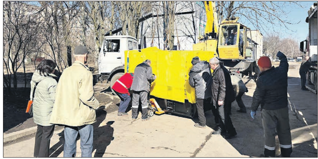
Nach der Fahrt quer durch Europa und der Ankunft in Zhofti Vody wird der Notstromgenerator sorgsam vom Lkw entladen. Foto: privat
