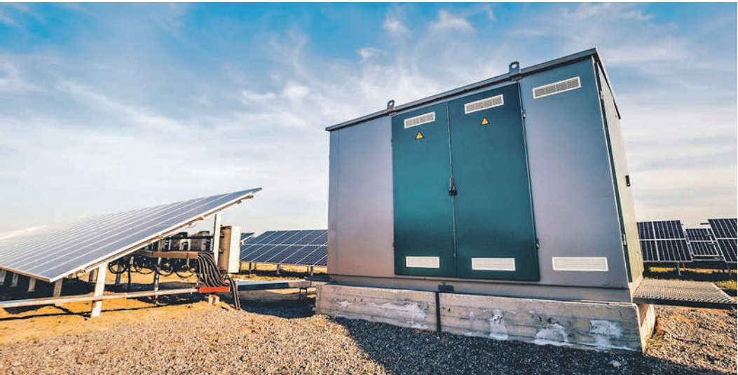
Ein Batteriespeicher bedeutet mehr Sicherheit und Nachhaltigkeit.
