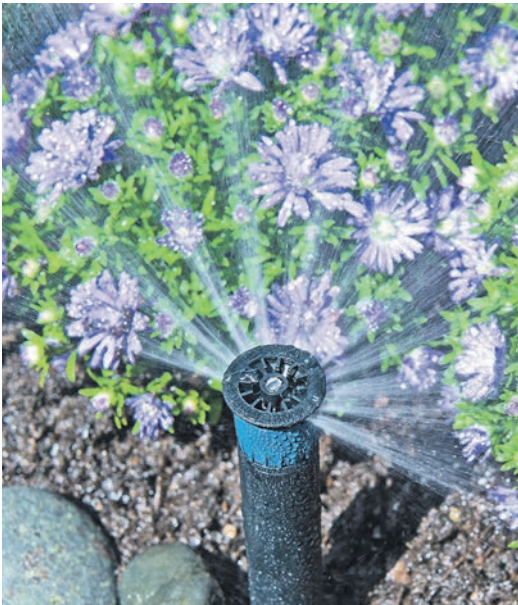
Bewässerungssystem gießen nur dann, wenn es notwendig ist. Das schont Ressourcen und spart bares Geld. Foto: DJD/Rainpro
