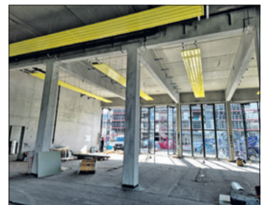
Gelbe Farbtupfer: In der Fahrzeughalle sorgen die Deckenstrahlplatten für Wärme.
