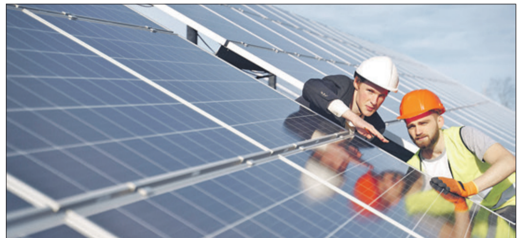
Solaranlagen für saubere Energie.
