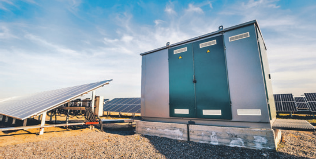
Ein Batteriespeicher bedeutet mehr Sicherheit und Nachhaltigkeit.
