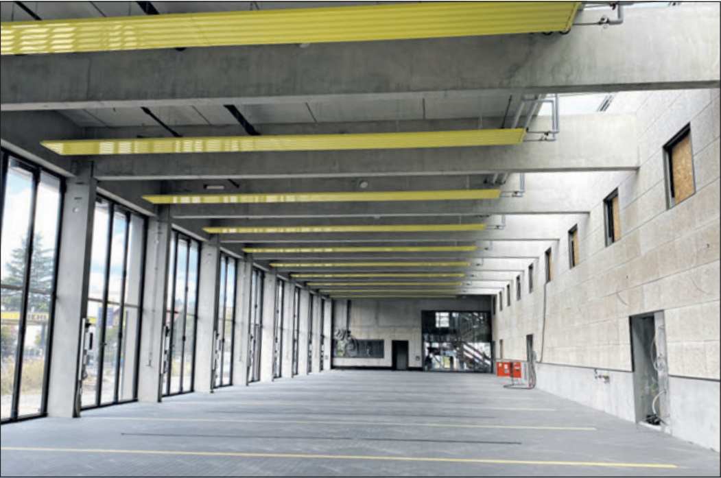
Blick in die Fahrzeughalle: Die gelben Verkleidungen an der Decke sind die Raumheizung. Fotos: Scholl
