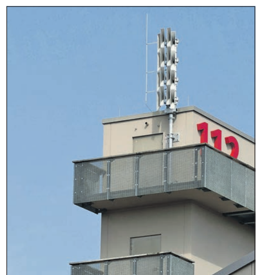
Die Richtsirene auf dem Turm des Notfallzentrums ist in ganz Eschborn zu hören
