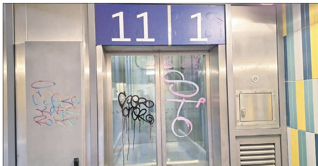
Schmierereien an der Front des Aufzugs
