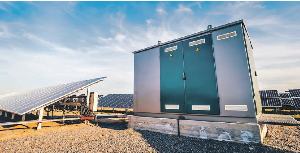
Ein Batteriespeicher bedeutet mehr Sicherheit und Nachhaltigkeit.
