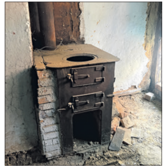
Der alte Herd aus der Küche im ersten Obergeschoss bleibt an seiner Stelle. Er wird später den Waschtisch halten, denn hier entsteht das neue Bad. Foto: Judith Ulbricht
