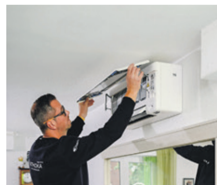
Kälte- und Klimafachbetriebe beraten bei der Auswahl und übernehmen Planung sowie Montage. Foto: DJD/DAIKIN/Carlos Albuquerque
