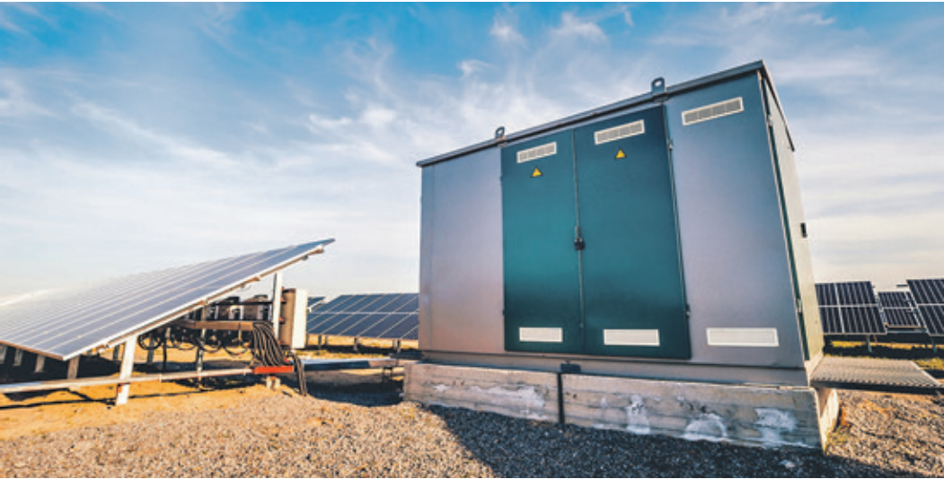
Ein Batteriespeicher bedeutet mehr Sicherheit und Nachhaltigkeit.
