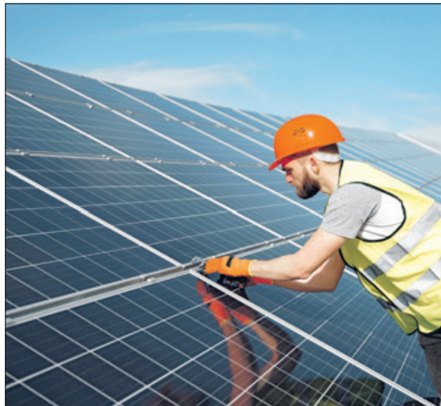
Der Ausbau von Photovoltaik und Batteriespeichern muss dringend vorangetrieben werden. Foto: pexels.com
