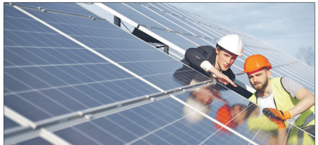
Solaranlagen für saubere Energie.
