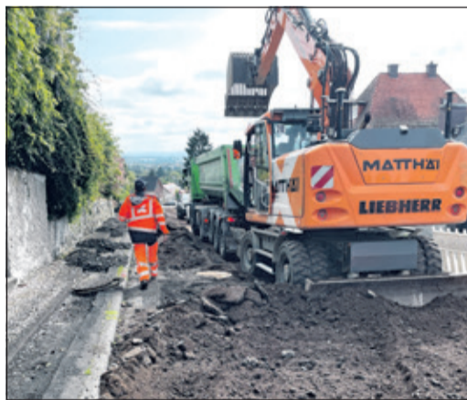
Der Bordstein auf der Nordseite ist schon geöffnet für Glasfaser. Links neben dem Bagger ist der Deckel des Hauptkanals zu sehen. Foto: as
