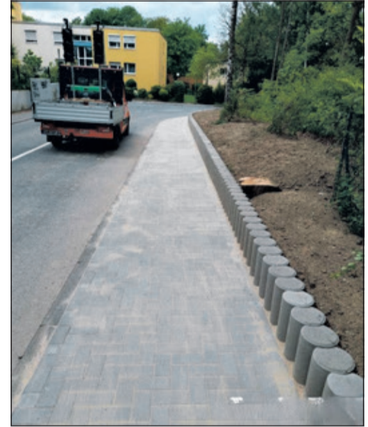
Für mehr Sicherheit: der neue Gehweg im Mammolshainer Weg. Foto: Stadt Königstein
