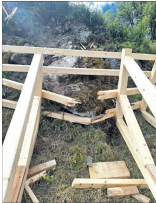
Der gelöste Felsbrocken hat den Prellbock zerstört, weiteren Schaden kann er jetzt nicht mehr anrichten. Foto: Stadt Königstein
