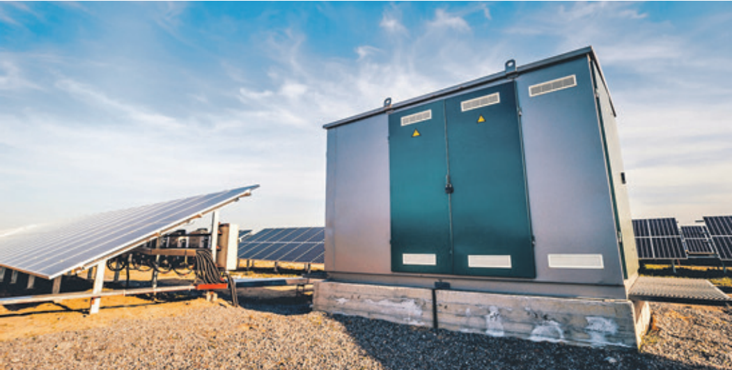
Ein Batteriespeicher bedeutet mehr Sicherheit und Nachhaltigkeit.
