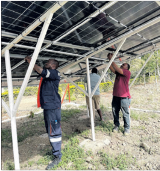
Das Installieren der Anlage geschah innerhalb weniger Monate. Foto: privat
