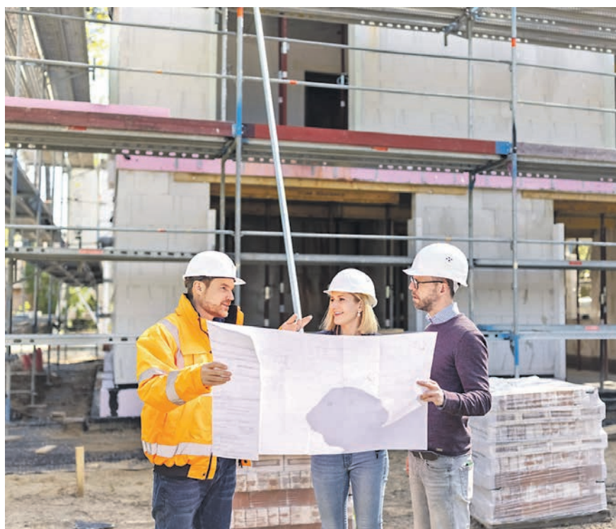
Unklare Baubeschreibungen und fehlende Abstimmung zählen zu den häufigen Ursachen von Baumängeln. Foto: DJD/Bauherren-Schutzbund/Getty Images/alvarez
