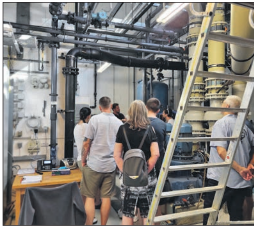
Bei der Führung im TaunaBad gibt es spannende Einblicke in die Schwimmbadtechnik. Foto: Stadtwerke Oberursel
