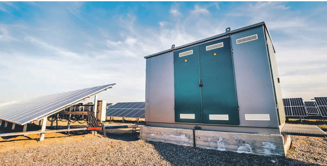
Ein Batteriespeicher bedeutet mehr Sicherheit und Nachhaltigkeit.
