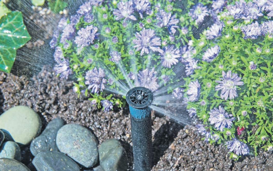
Bewässerungssystem gießen nur dann, wenn es notwendig ist. Das schont Ressourcen und spart bares Geld. Foto: DJD/Rainpro
