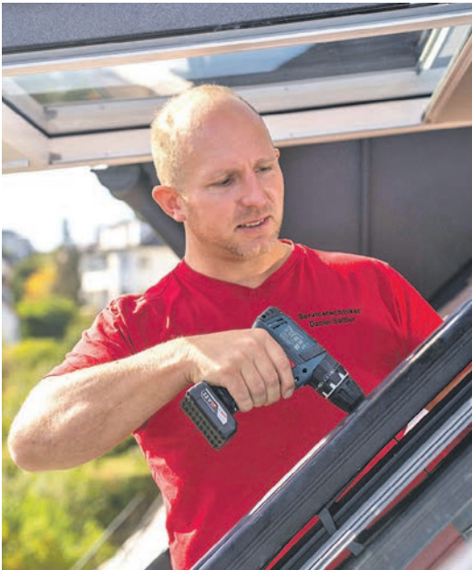
Besonders bei Dachfenstern, die konstruktiv noch in gutem Zustand sind, lassen sich viele typische Verschleißerscheinungen wirtschaftlich sinnvoll beheben. Foto: DJD/TLS-Dachfenster
