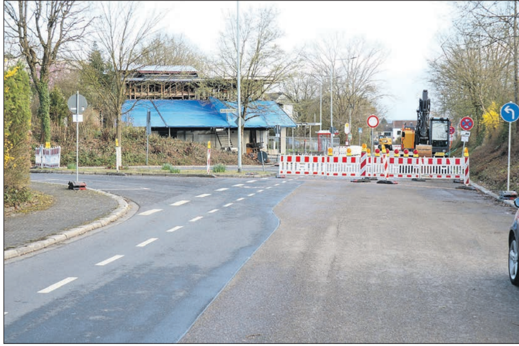
Seit Montag ist der Westring zwischen Mecklenburger- und Hessenstraße gesperrt, weil dort ein neuer Abwasserkanal verlegt wird. Foto: te
