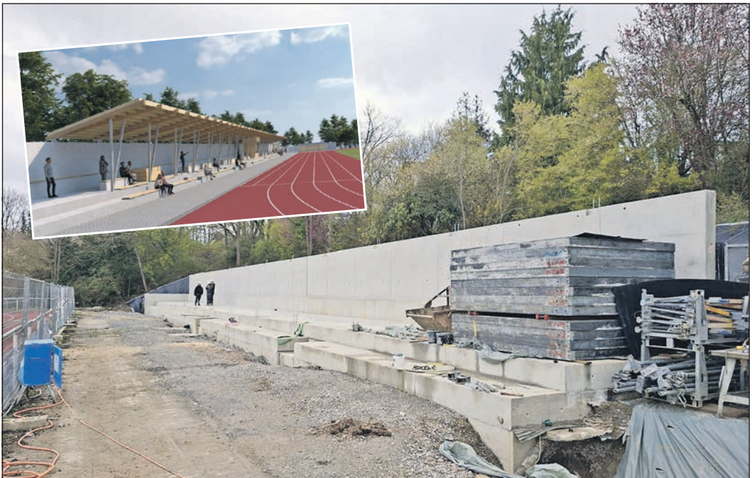
Der erste Bauabschnitt der neuen Tribüne am Limesstadion ist fertig. Bis zum Spätherbst soll auch die Dachkonstruktion stehen, die für Schatten und Lärmschutz sorgen soll. Darüber hinaus werden auch noch zwei Nebengebäude errichtet. Foto/Gafik: Stadt Schwalbach
