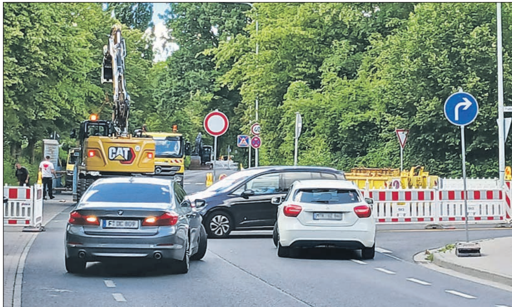
Anfang der Woche ist die Baustelle am Westring in den letzten Abschnitt zwischen der Frankenstraße und der Pommernstraße „gewandert“. Am Dienstagnachmittag herrschte vor den neuen Baken an der Frankenstraße bisweilen noch etwas Chaos. Foto: Schlosser
