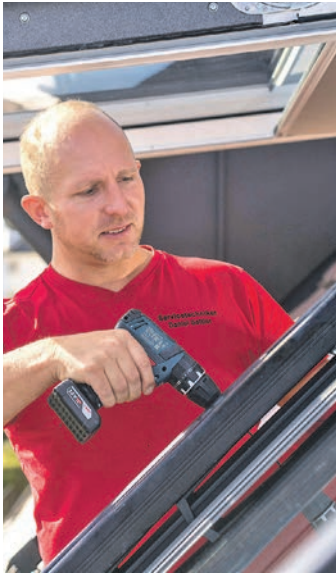
Besonders bei Dachfenstern, die konstruktiv noch in gutem Zustand sind, lassen sich viele typische Verschleißerscheinungen wirtschaftlich sinnvoll beheben. Foto: DJD/TLS-Dachfenster
