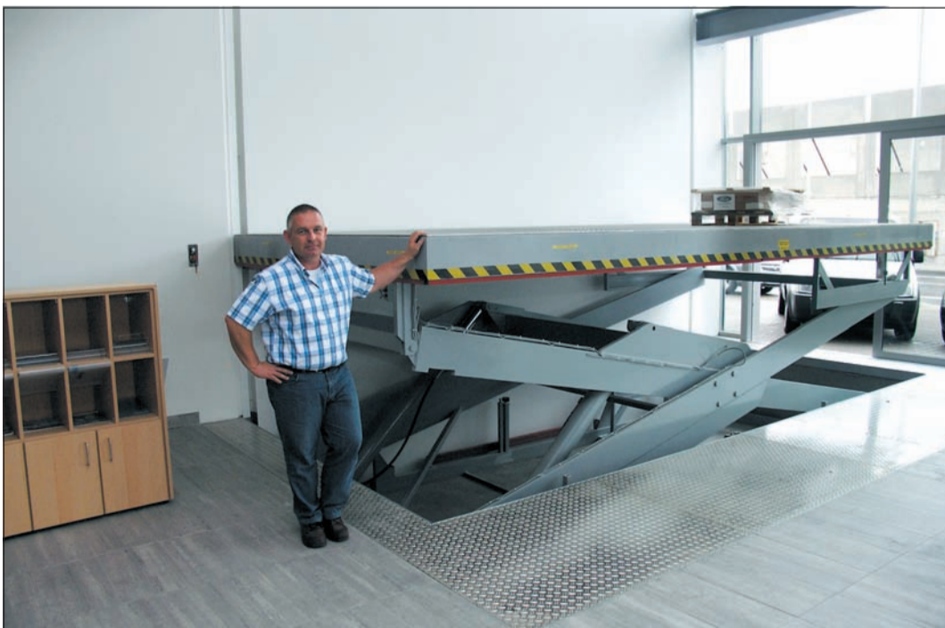
Knut Kreissl an der Scheren-Hebebühne, mit der Mazda-Fahrzeuge ins Obergeschoss gehievt werden.
