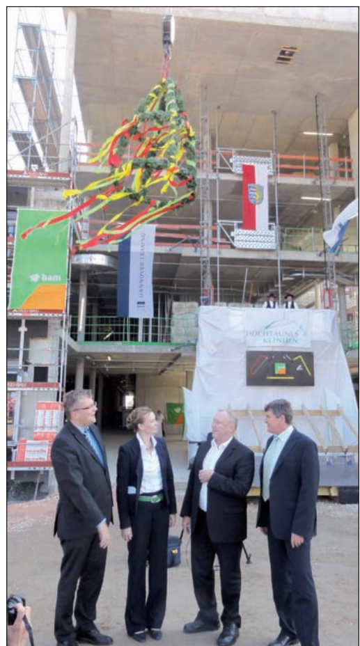
Landrat Ulrich Krebs, die Geschäftsführerin der Kliniken Julia Hefty, Oberbürgermeister Michael Korwisi und Jochen Metzner vom hessischen Sozialministerium (v.l.) zeigten sich hochofren über den zügigen Fortgang der Bauarbeiten am neuen Klinikum.
