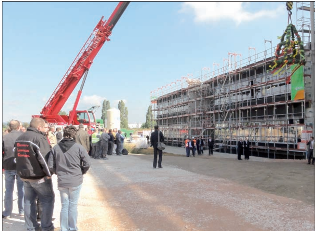
Hunderte Gäste und Handwerker waren zum Richtfest auf die Baustelle der Hochtaunus-Kliniken gekommen. Foto: a.ber
