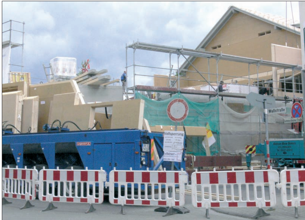
Die Baustelle an der Wallstraße/Ecke Bommersheimer Straße, hier soll das neue Gemeindezentrum entstehen. Foto: bg
