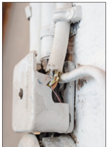
Gefahr für Leib und Leben, Haus und Hof: Alte, zu klein dimensionierte und marode Elektroinstallationen können für Stromschläge und Brände verantwortlich sein. Foto: djd/Elektro+
