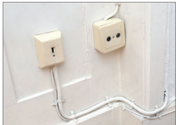
Überalterte Elektroinstallationen können eine nicht zu unterschätzende Gefahrenquelle darstellen. Foto: djd/Elektro+
