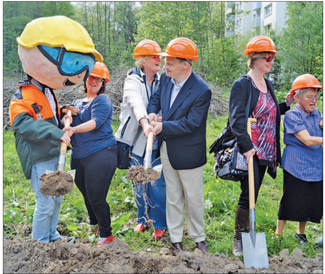
Gemeinsam vollzogen Ehrengäste und künftige Bewohner zusammen mit „Milgi“ (links) den ersten Spatenstich für das neue Wohnhaus im St. Hedwigs-Weg. Foto: hs
